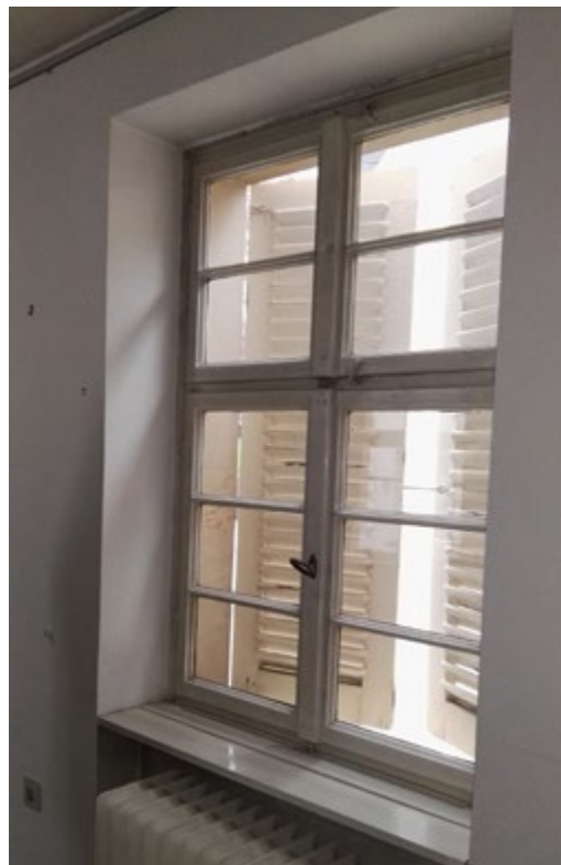
11. Wärmebrücken am Fenster: Sturz, Laibung und reduzierte Wandstärke im Brüstungsbereich
