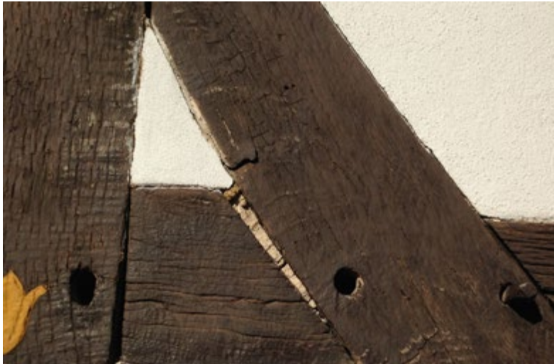
32. Fachwerkfassade, erhebliche Feuchtebelastung über die Fugen Gefach/Holz
