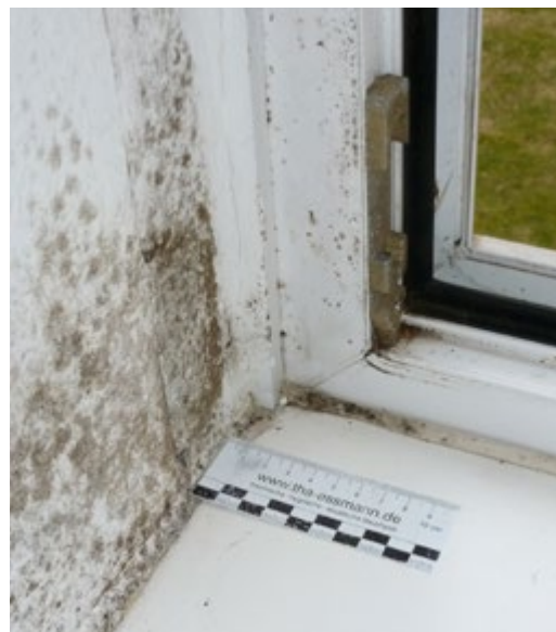
39. Die Wärmebrücke an der ungedämmten Fensterlaibung verursacht Kondensat und Schimmelbildung
