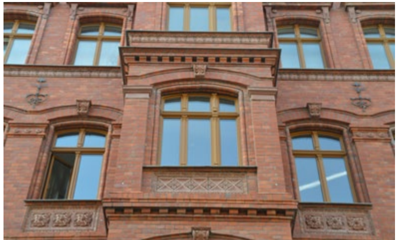
15. Der hohe Fugenanteil der Ziegelfassade bedingt einen erhöhten Feuchteeintrag bei Schlagregen.
