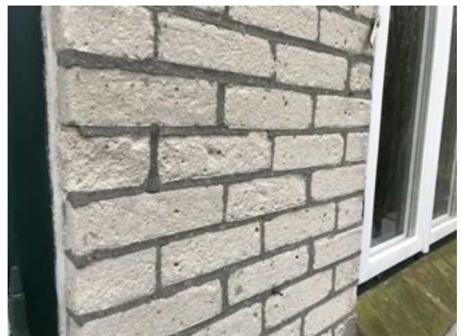
36. Nicht frostbeständiges Mauerwerk, Schadensbild nach erfolgter Hohlraumdämmung
