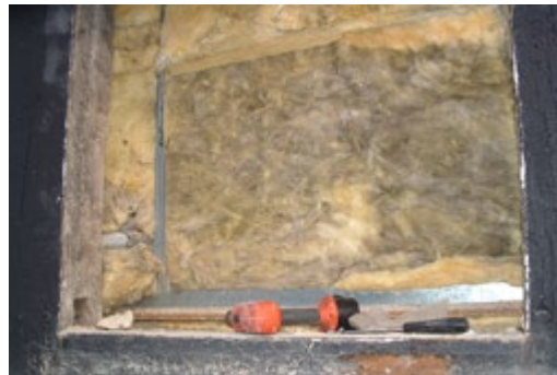
8. Durch Konvektion verursachte Kondensatbildung führte zu Schimmelbildung in der Dämmschicht.
