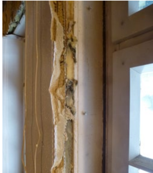
38. Schimmelbildung in der Dämmschicht
