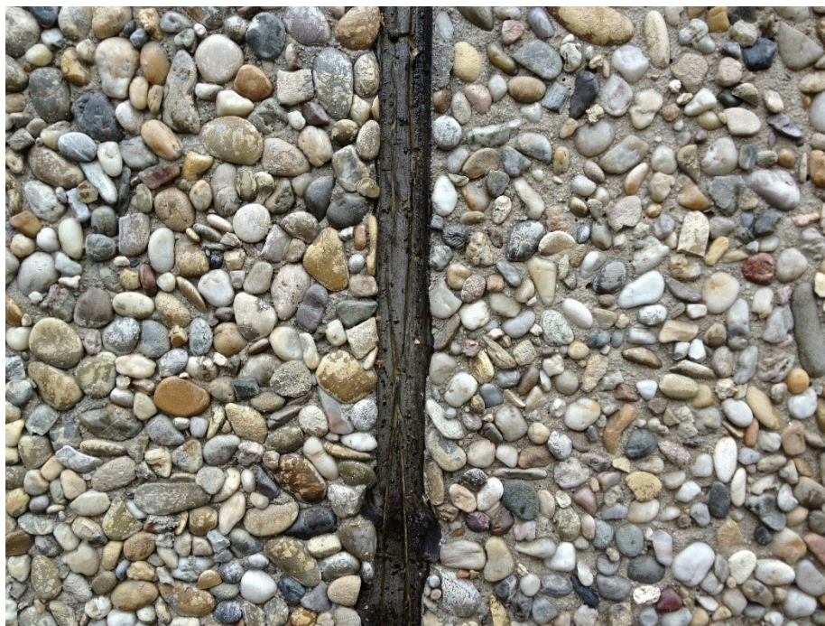
Abbildung 4: PCB-haltige Fugendichtmasse, hier zwischen Waschbetonplatten einer Vorhangfassade.
