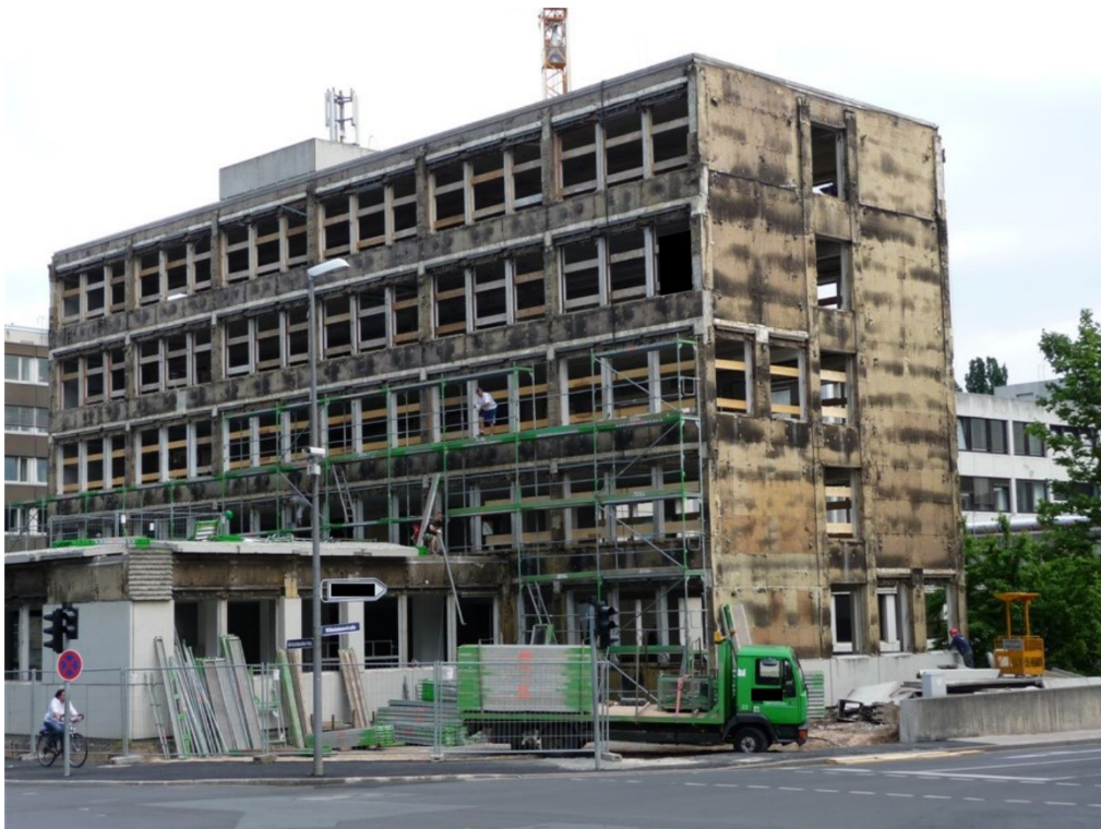
Abbildung 3: Freiliegende KMF-Dämmung nach Rückbau der Fassadenbekleidung.
